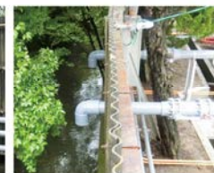
最終ゲート排水ポンプ
