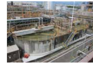
排水処理設備
