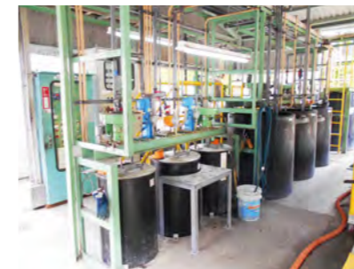
凝集沈殿処理設備
