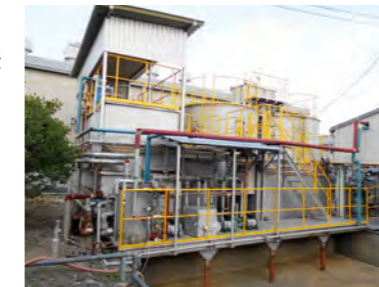
活性汚泥処理設備
