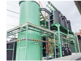
凝集沈殿方式の処理設備
