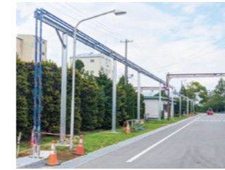
漏洩、異常事態の早期発見に有効な地上配管
